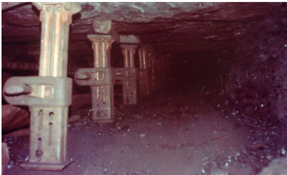
全球最短之「 摩擦鐵柱 」支撐於煤厚45公分之採煤面實況
