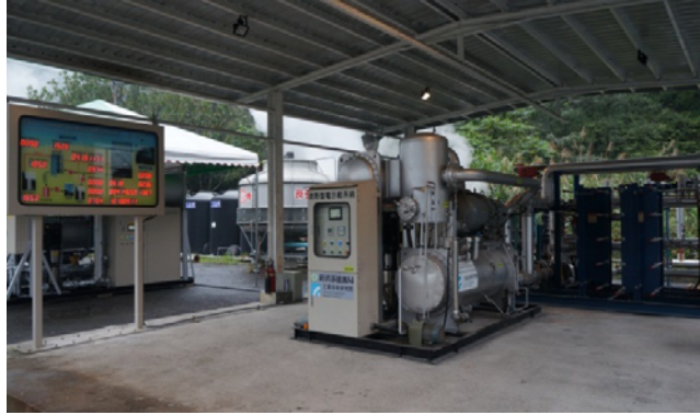
宜蘭清水 50kW 地熱增強型雙循環發電示範系統
